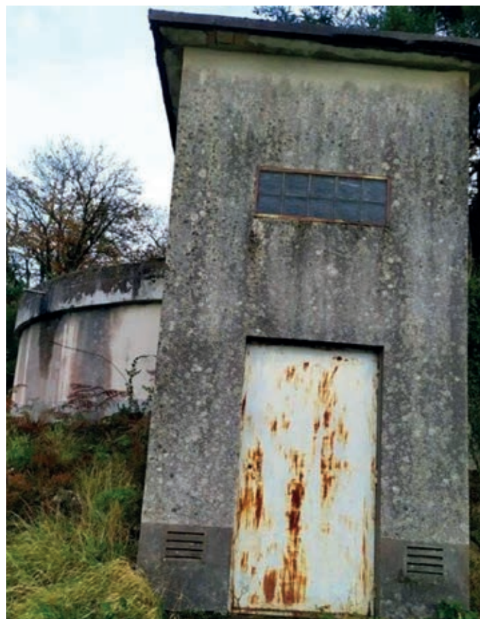
État vétuste du réservoir du Gaulier.
